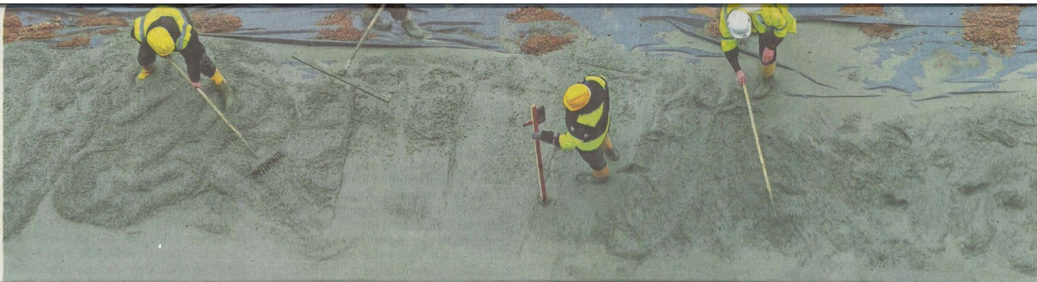
Bauarbeiten: Ein Architekt kann im Fall von Mängeln auch mit dem Einsatz eines Sonderfachplaners haften.
